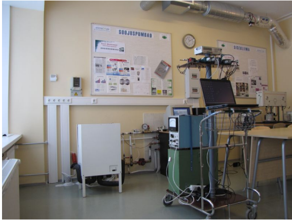
Joonis 1. Maasoojuspump Booster SP, ventilatsioonisüsteemi väljatõmbeava ja -toru ning diagnoosiseadmetega kärustatiiv
